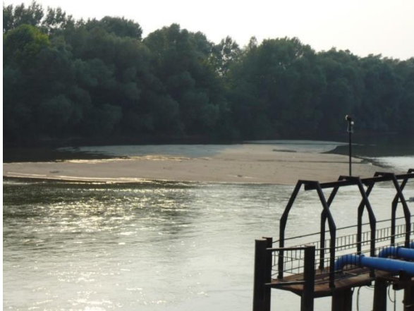
Az átemelő szivattyúnál 2011.
